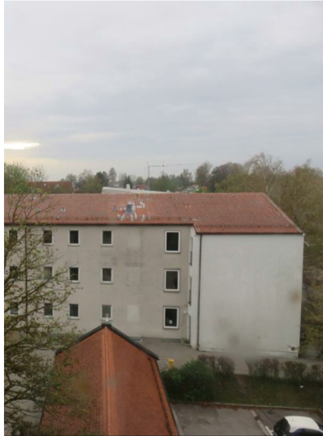
Verwitterte / perforierte Fassade
